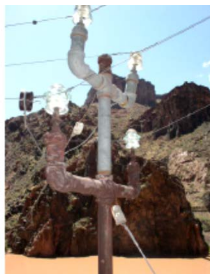
Εικόνα 5.1.α: Εγκατεστημένο τηλεφωνικό δίκτυο
