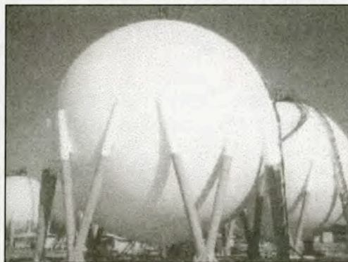
Εικόνα 7.1.2 Σφαίρα αποθήκευσης υγραερίου σε διυλιστήριο
