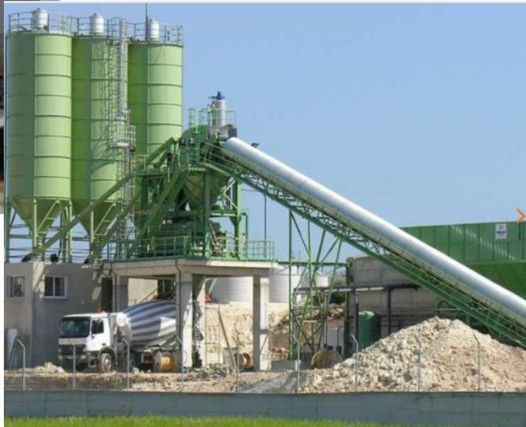
Εικ.2 : Συγκρότημα παραγωγής σκυροδέματος
