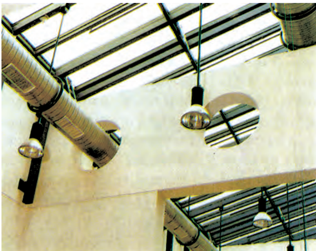
Εικόνα 1.18. Κλιματισμός με εμφανείς αεραγωγούς σε βιομηχανικό χώρο
