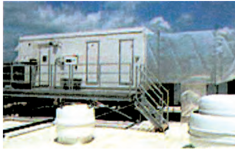
Εικόνα 1.17. Κεντρική μονάδα κλιματισμού αίθουσας χειρουργείου
