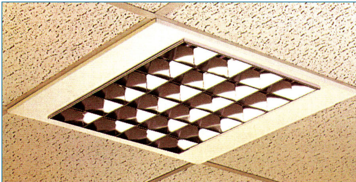
Σχήμα 4.6: Φωτιστικό σώμα με περσίδες
