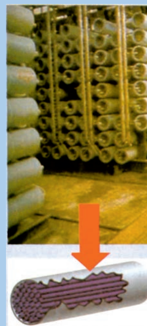
Πάνω. Ο εσωτερικός χώρος σύγχρονης μονάδας αφαλάτωσης με αντίστροφη ώσμωση.
