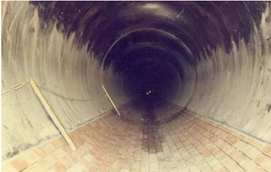
Εικόνα 4.6: Κεντρικός Αποχετευτικός Αγωγός (ΚΑΑ) Θεσσαλονίκης (ΤΕΕ, 2018).
