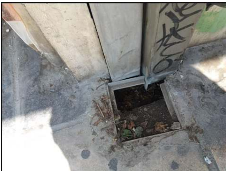
Εικόνα 7.2: Υδρορροή πολυκατοικίας στο κέντρο της Θεσσαλονίκης.
