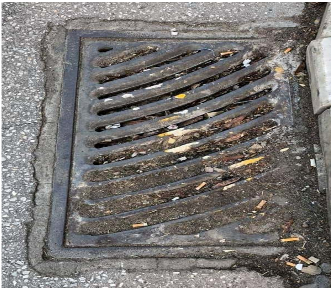
Εικόνα 6.4.1: Βουλωμένο φρεάτιο επί της οδού Εθνικής Αμύνης.
