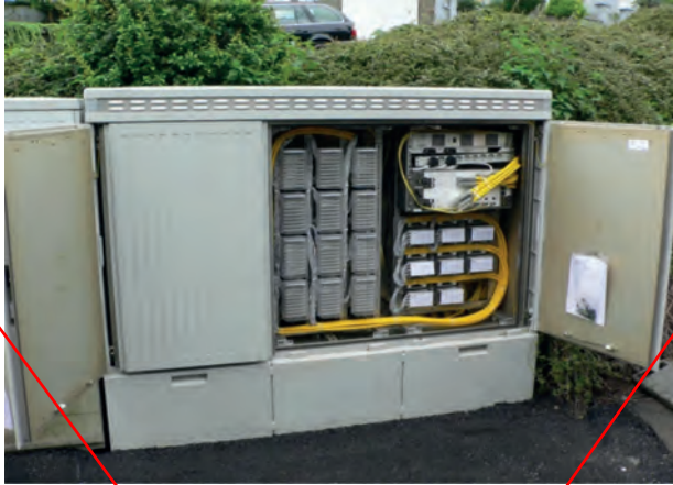
Εικόνα 5.1.4.1.β: Εξωτερικό DSLAM
