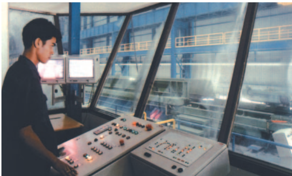
Σχήμα 3.10: Τράπεζα χειρισμών εγκατάστασης αυτοματισμού.
