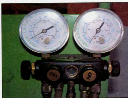
Σχήμα 7: Διπλό πιεσόμετρο για τον έλεγχο του συστήματος κλιματισμού.
