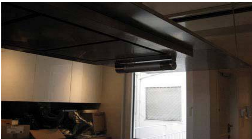
Σύστημα πυρόσβεσης BONPET σε χώρο της κουζίνας.
