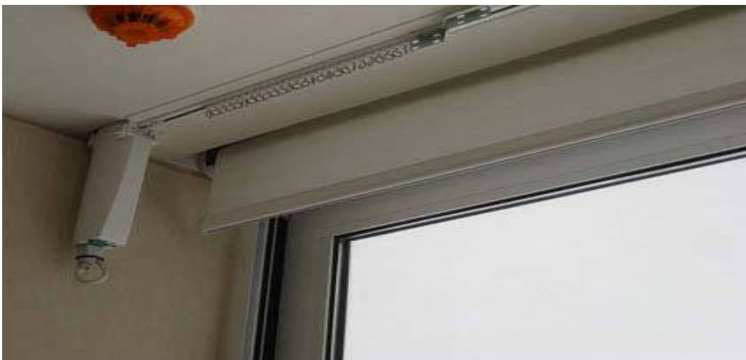
Σύστημα διαχείρισης ρολών σε κατοικία.
