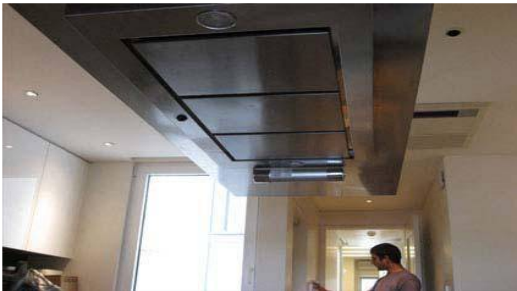
Σύστημα πυρόσβεσης BONPET σε χώρο της κουζίνας.
