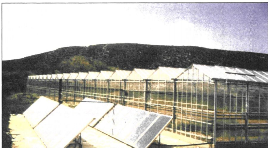
Εικ. 4.21. Ηλιακοί συλλέκτες που αποδίδουν θερμότητα στο θερμοκήπιο.
