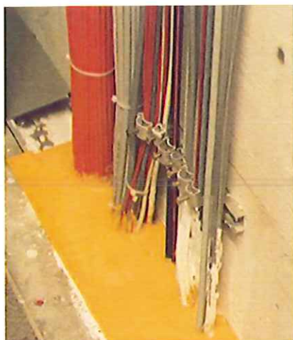
Εικόνα 46 Με πυρίμαχο υλικό καλύπτονται τα ανοίγματα μεταξύ των ορόφων
