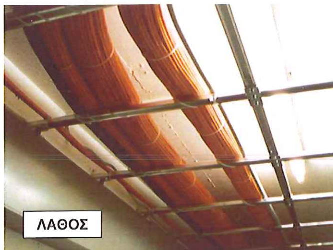
Εικόνα 44 Διέλευση καλωδίων UTP κοντά από λάμπες φθορισμού
