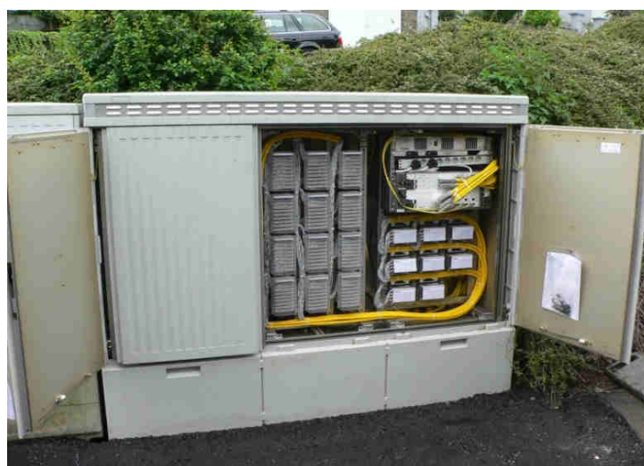
Εικόνα 5.1.4.1.β: Εξωτερικό DSLAM
