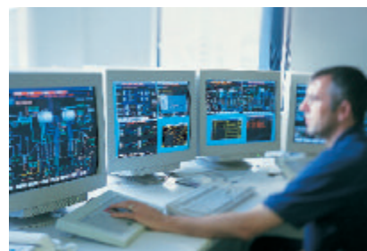
Λύσεις απομακρυσμένης διαχείρισης που περιλαμβάνουν SCADA, δικτύωση, Τηλεμετρία και Βιομηχανικά Μόντεμ.
